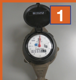
Medidor de agua
