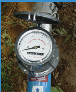
2. Medidor de agua
